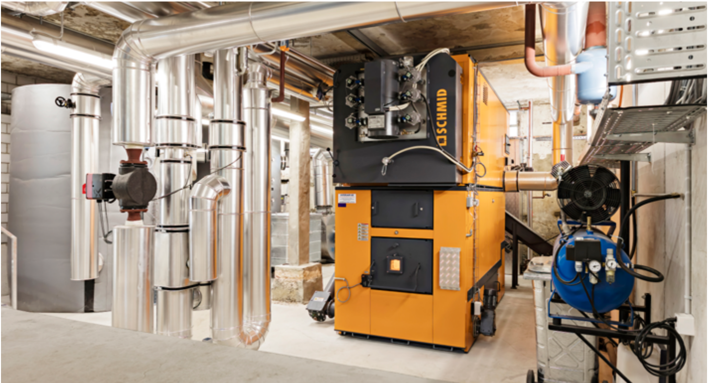
Rund 200 Tonnen weniger CO 2 stösst die neue Holzsnitzelheizung pro Jahr aus.
