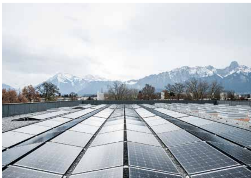
Mit der Photovoltaikanlage erreicht das Gebäude den Plusenergiestandard.
