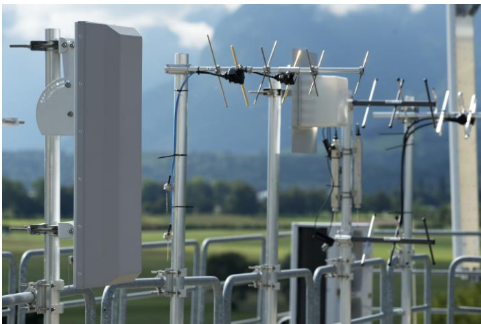
Fig. 1: antenne fisse ad alta efficienza
