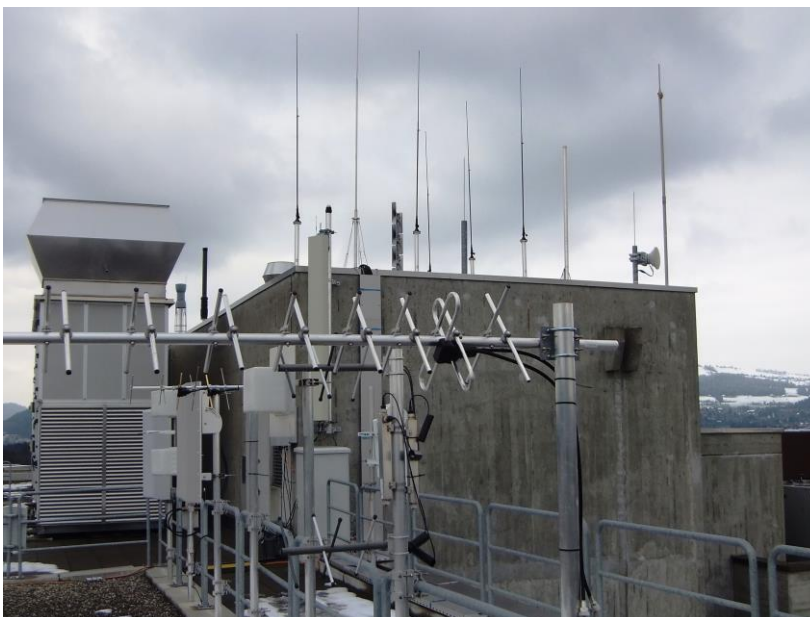
Abb 1: Leistungsfähige montierte Antennen
